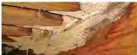
Мал. 235. Дерев'яна будівля, уражена домовим грибом
